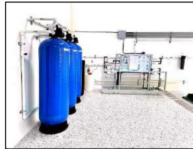
Planta de procesamiento de agua
