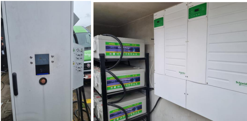
Centro de carga
